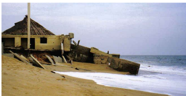
Figure 5: Erosion côtière causée par l'interruption de l'amoncellement du sable le long de la côte du fait de la construction, à quelques kilomètres de distance, du Port de Cotonou au Bénin. (Photo R. Arthurton)
